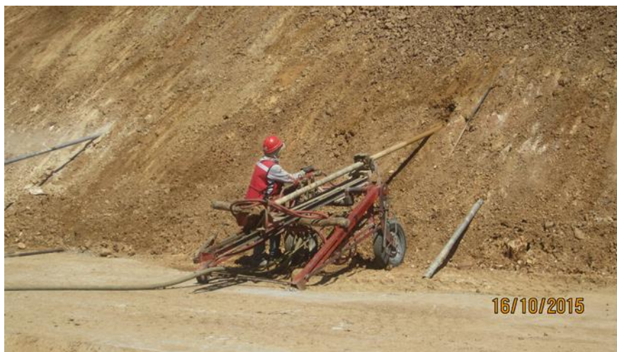
Figura 1.2 Wagon drill en perforación para introducción de drenes. Fuente: Fotografía propia. Construcción carretera Jala-Compostela.
