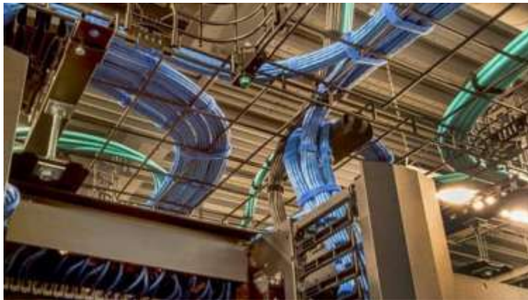
Figura 14. Cableado de voz y datos
