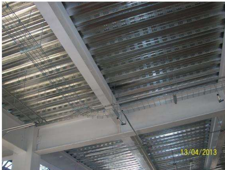
Figura 12. Instalaciones eléctricas y tuberías
