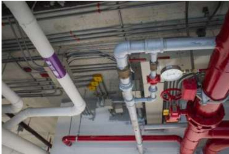
Figura 16. Instalación contra incendio
