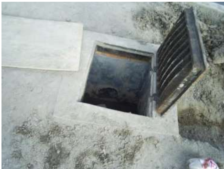
Figura 11. Depósito de recolección de agua pluvial
