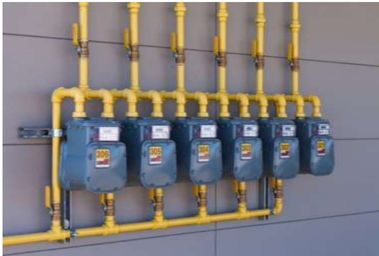
Figura 13. Instalaciones de gas
