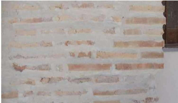
Figura 4. Rehabilitación del Hospital San Juan de Dios en Granada - Detalle del muro
