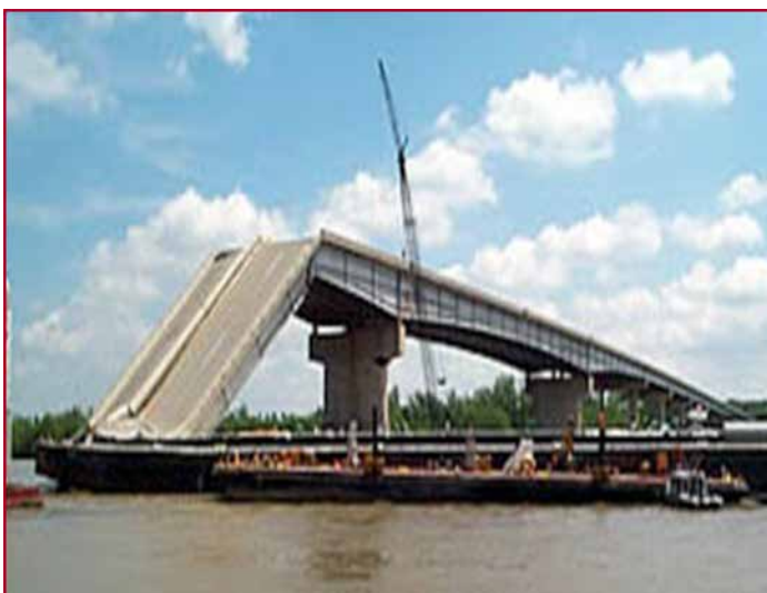
Foto 2A - Puente I-40 cerca de Oklahoma City (Oklahoma, Estados Unidos) que falló cuando una barcaza, fuera del canal y que viajaba aguas arriba, golpeó y dañó una columna del puente, causando la caída del claro
